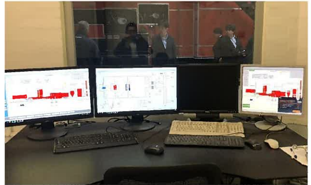
プラントの稼働は全てシステム化されており、スマートフォンでのリモート操作で制御できるとのことであった
